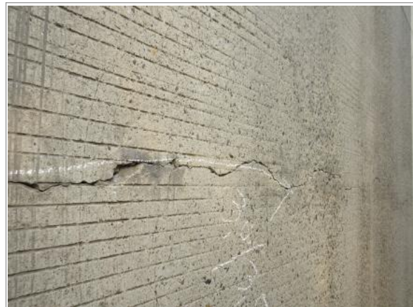
Span3 포장면 균열
