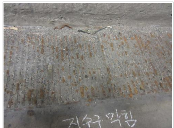
Span93 집수구 토사퇴적 및 스틸그레이팅 부식
