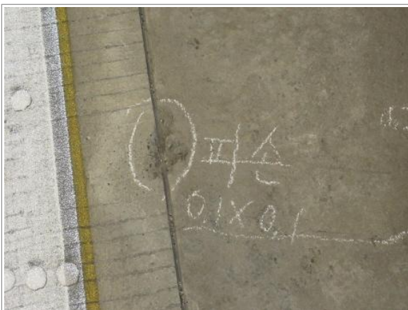
Span8 포장면 파손
