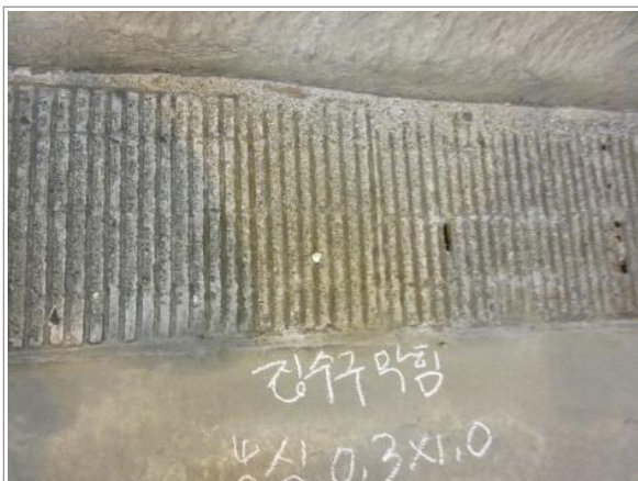
Span24 집수구 토사퇴적 및 스틸그레이팅 부식
