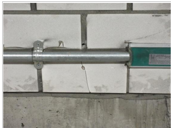
Span95 측벽부 타일 파손(균열)
