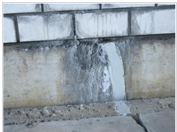
Span181 벽체부 백태(0.3×0.5)
