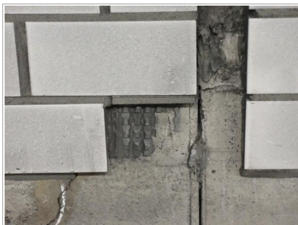
Span104 측벽부 타일 탈락
