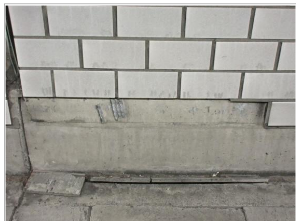
Span142 측벽부 타일 탈락
