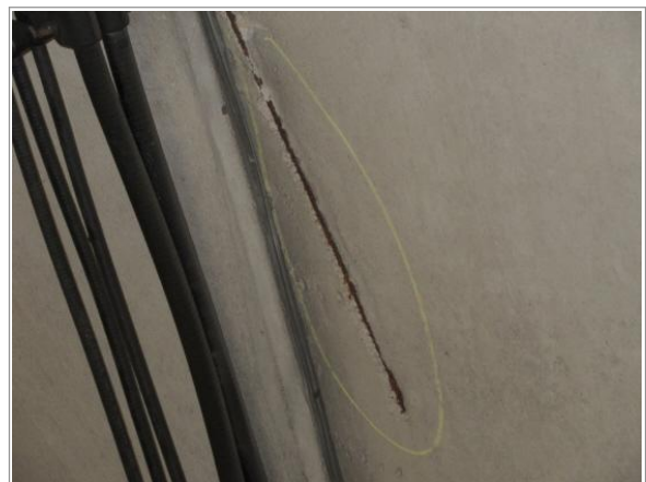
Span128 천단부 철근노출(0.1×0.5)
