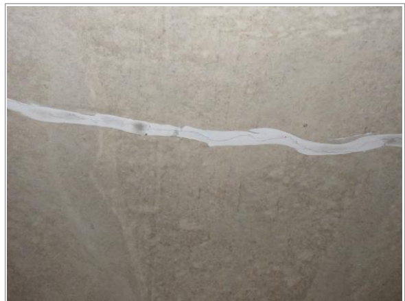
Span90 천단부 종균열(cw=0.2mm/9.0m, 보수부 재균열)
