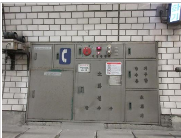
소화기 및 비상전화, 비상콘센트 전경
