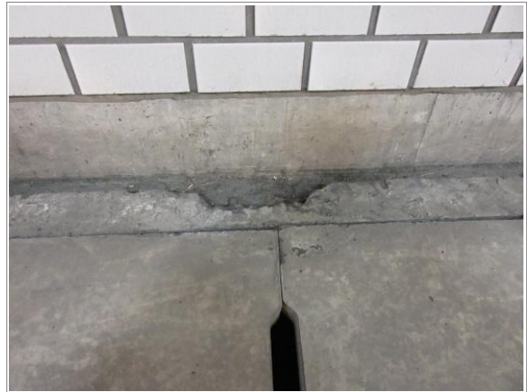
Span24 공동구 벽체 파손(0.1×0.3)
