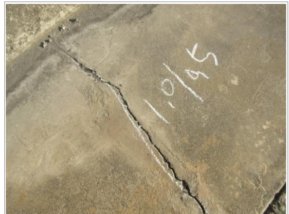
Span1 측구 균열(1.0mm/0.5m)
