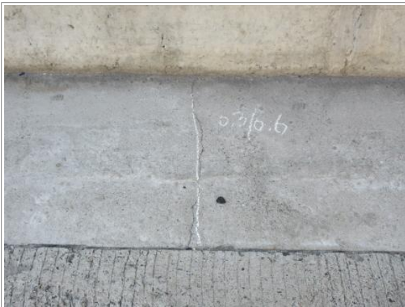
Span1 측구 균열 (0.3mm/0.6m)
