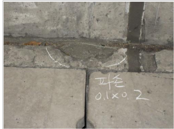
Span3 공동구 벽체 파손(0.1×0.2)
