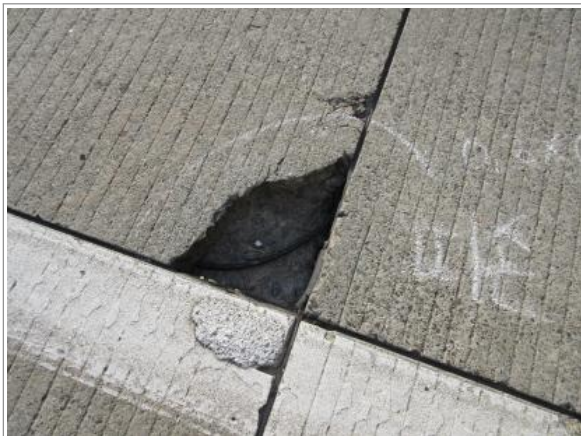
Span1 포장면 파손
