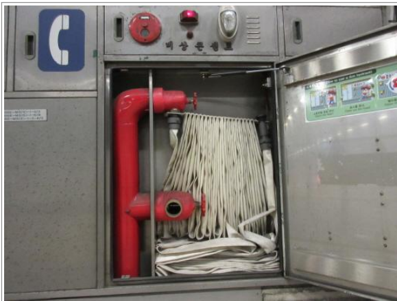
소화시설 및 비상전화, 비상콘센트 전경
