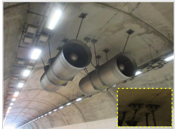
환기시설 전경 (체결상태)
