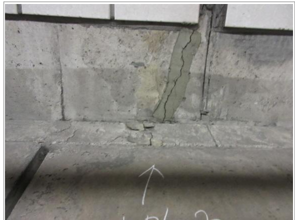
Span43 벽체부 횡균열(cw=1.0mm/0.3m, 보수부 재균열)
