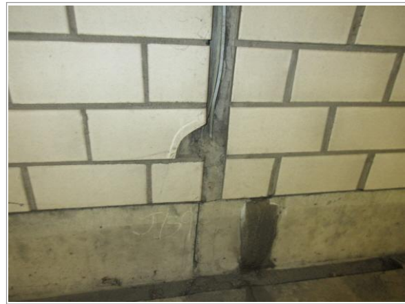
Span158 측벽부 타일 파손
