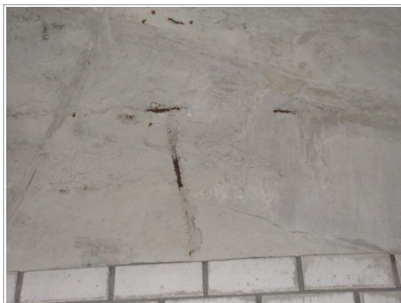
Span56 벽체부 철근노출(0.1×0.3)
