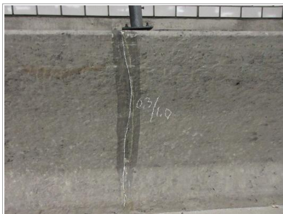
Span29 공동구 벽체 균열(0.3mm/1.0m)
