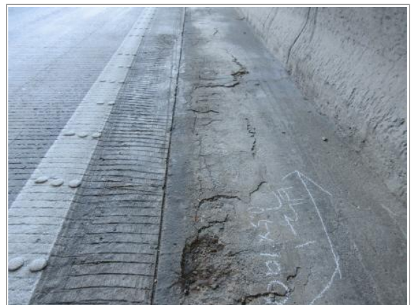
Span182 측구 박리(0.5×10.0)
