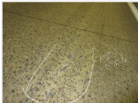
Span144 포장면 재료분리
