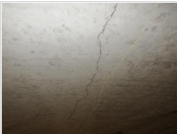
Span62 천단부 종균열(cw=1.5mm/9.0m)
