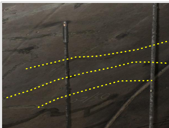
Span179 천단부 종균열(cw=0.2mm)
